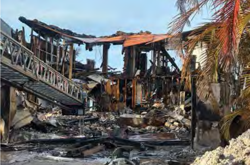
Một ngôi nhà bên bờ biển bị phá hủy do hỏa hoạn trong cơn bão.
